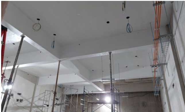
Instalaciones internas nivel 1
