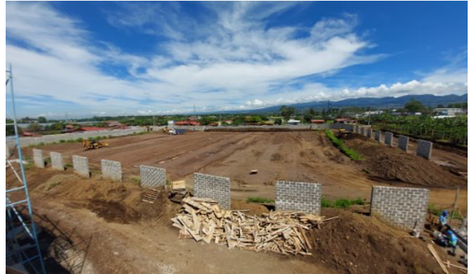
Terraza de paneles solares
